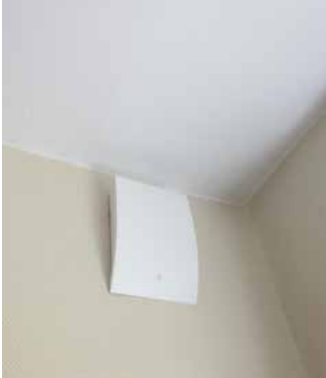
Datensammler im Treppenhaus
